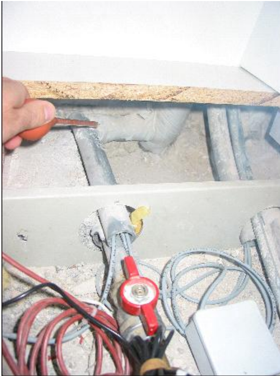
Figur 24: Heizungssteigzone und Bodenheizungsverteiler (vorne)
