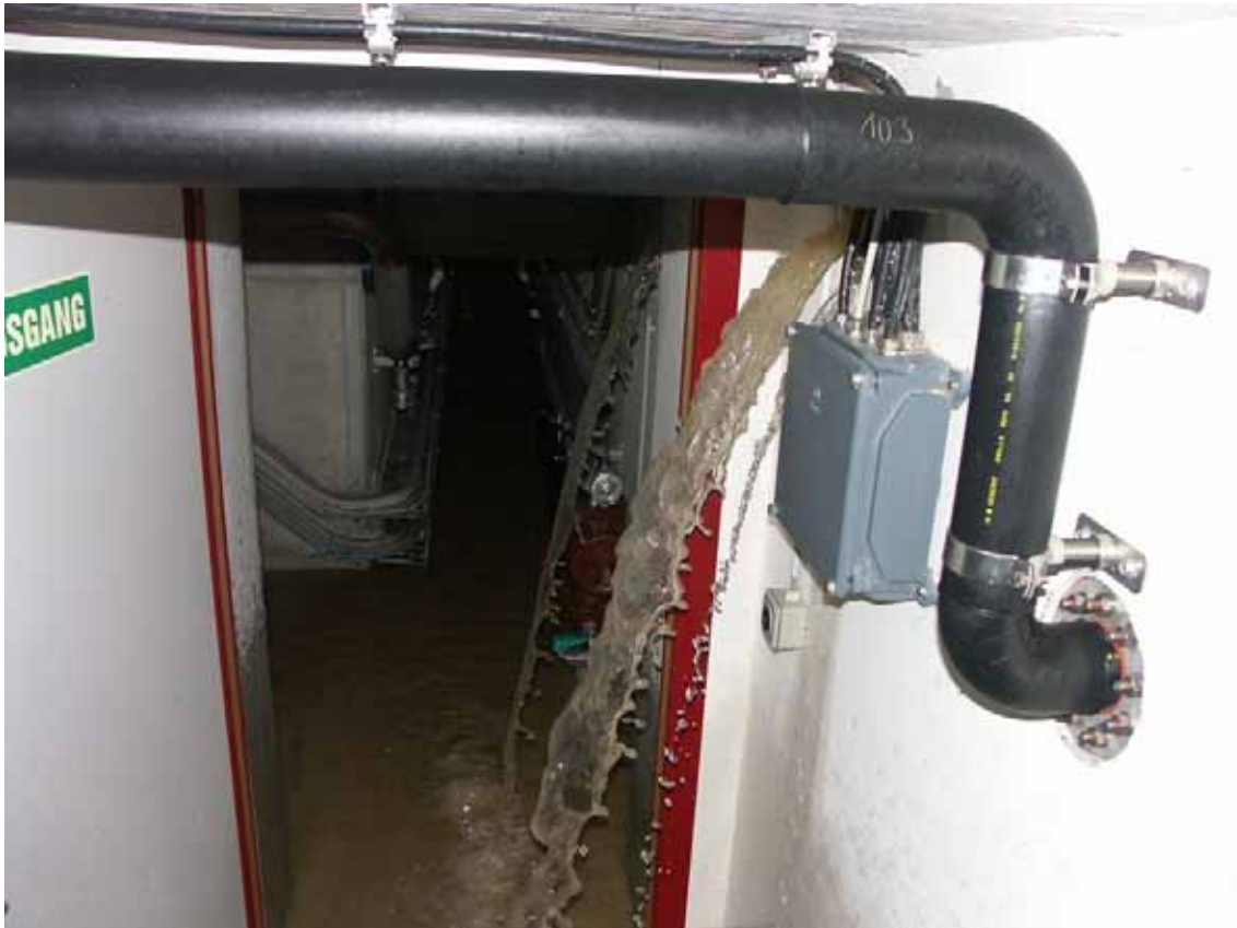
Bild 7: Wasser dringt über Kabelkanal in Keller
