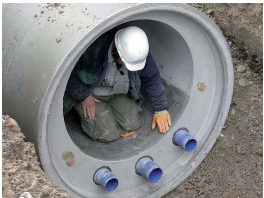
Abbildung 9: Bei der Herstellung des Kanalisationsrohrs bereits integrierter Wärmetauscher (Eawag)
