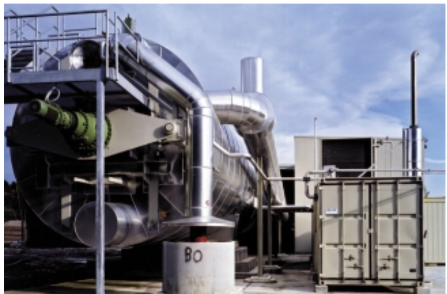
Treibstoff, Strom und Wärme aus Abfall: Reaktor zur Biogaserzeugung
